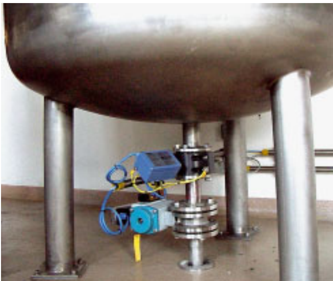
Rengasanturi asennettuna faasitunnistimeksi erotussäiliön vesityslinjaan.
