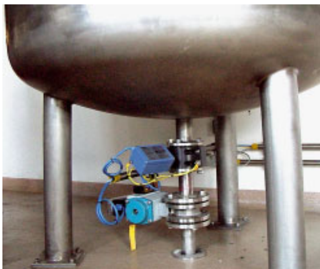
Rengasanturi asennettuna faasitunnistimeksi erotussäiliön vesityslinjaan.
