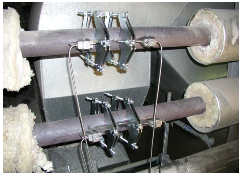
Fluxus-anturit asennettuna kattilan syöttöveden määrän mittaukseen, lämpötila +280 °C
