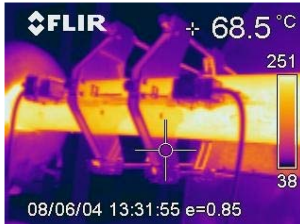
Lämpökamerakuvassa bitumiputkesta nähdään, että mittausantureiden kohdalla lämpötila on noin 40 °C. Mittaus voidaan toteuttaa tavanomaista anturia ja Waveinjectoria käyttäen.
