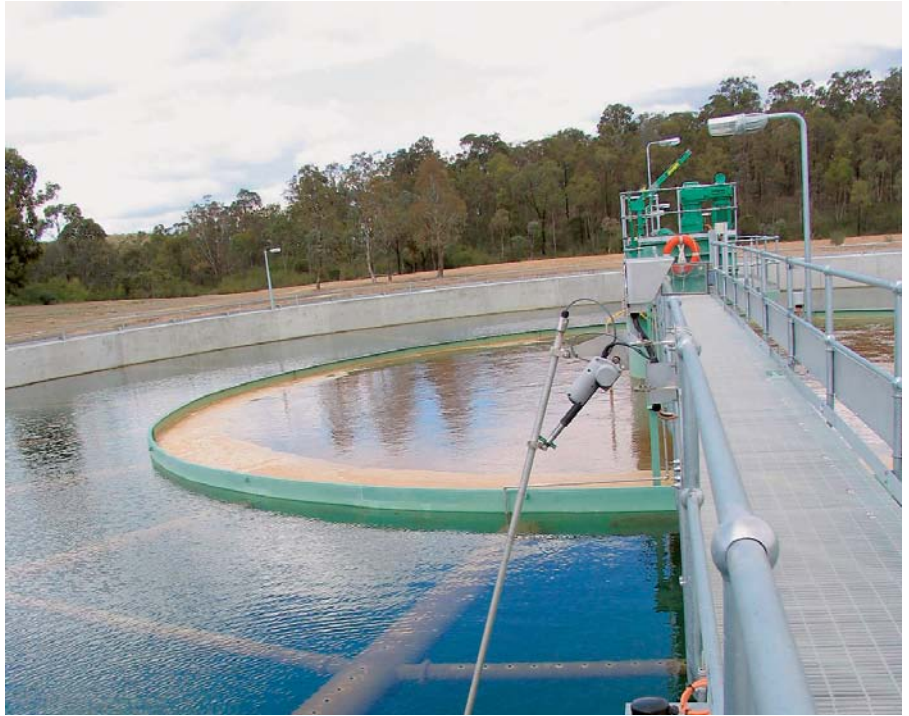
Automaattinen puhdistusjärjestelmä aktivoituneena
