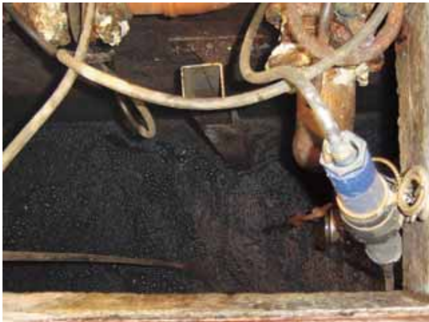
Kuvan tiivistetyn jätelietteen betonisessa varastosäiliössä on paksua vaahtoa, kaasutilassa on kylläistä vesihöyryä ja paljon erilaisia rikkiyhdisteitä. Säiliössä on myös voimakas sekoitus ja muuta kuvassa näkyvää "tavaraa". Tässä tarvitaan erittäin suorituskykyinen päältä mittaava, kosketukseton pinnanmittausjärjestelmä.
