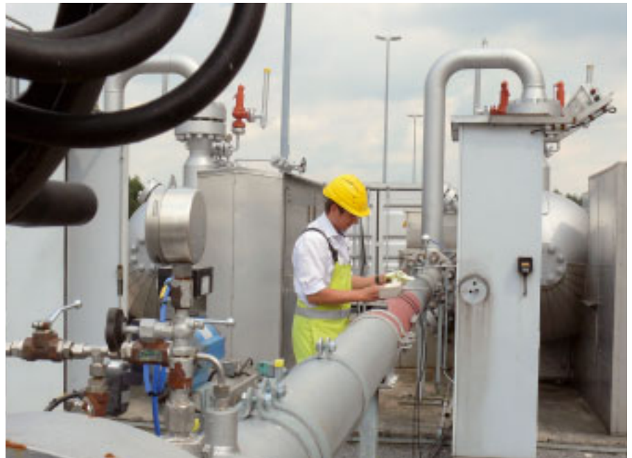
Sebastian Vreeman Fleximiltä suorittamassa mittausjärjestelmän asennusta ja käyttöönnottoa laitoksen käynnin aikana.
